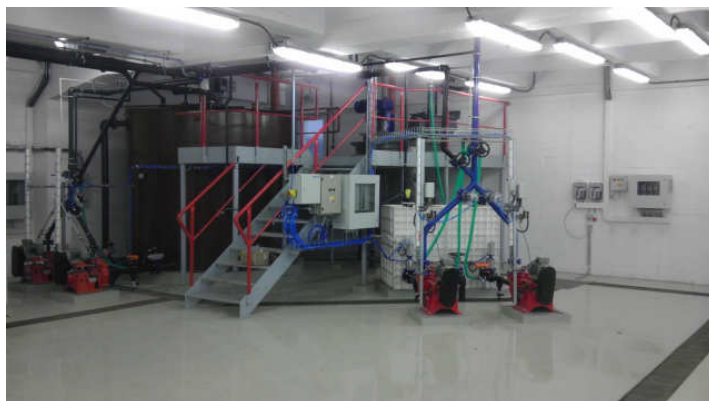
Pohled na technologii
